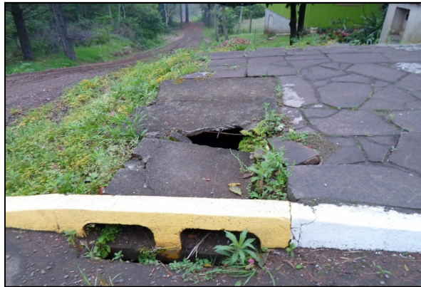
Figura 13: Vista de boca de lobo danificada.
