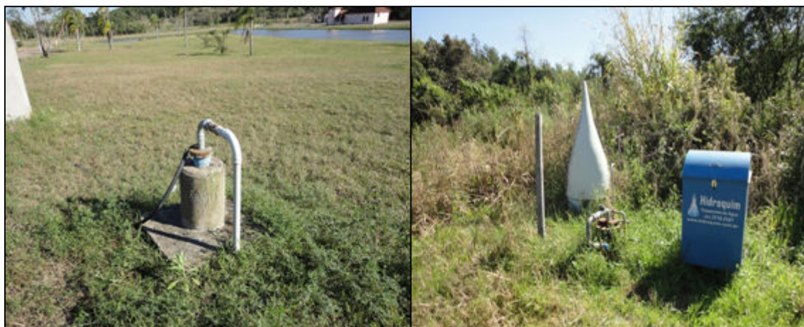
Figura 04: Poços de captação sem proteção ou cercas no entorno.
