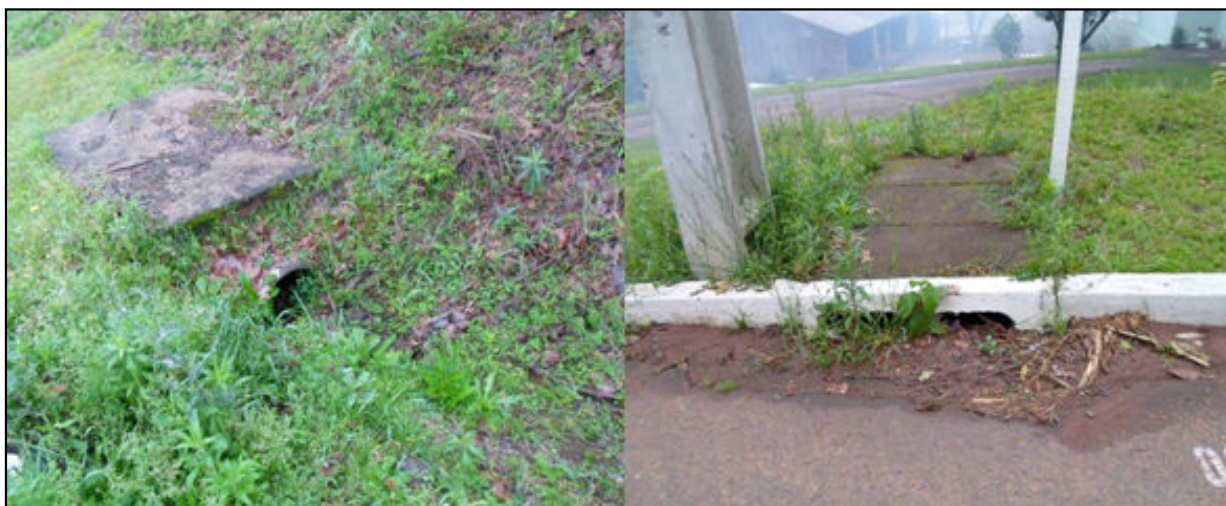
Figura 19: Bocas de lobo parcialmente obstruídas por vegetação e acúmulo de sedimentos.
