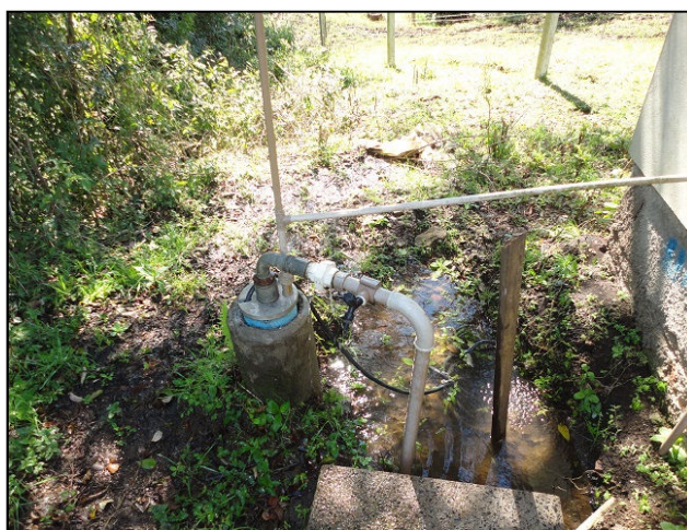
Figura 07: Vazamento de água no poço de Vila Rica.
