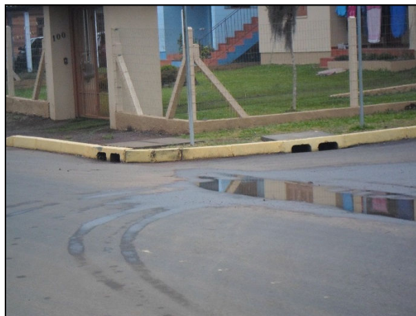
Figura 14: Bocas de lobo e acúmulo de água na rua.
